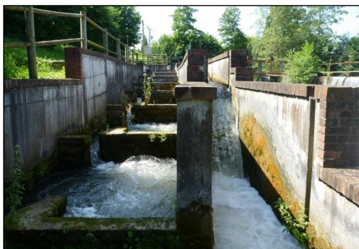
Figure 3 : Passe à bassins successifs du barrage du Breuil-en-Auge
